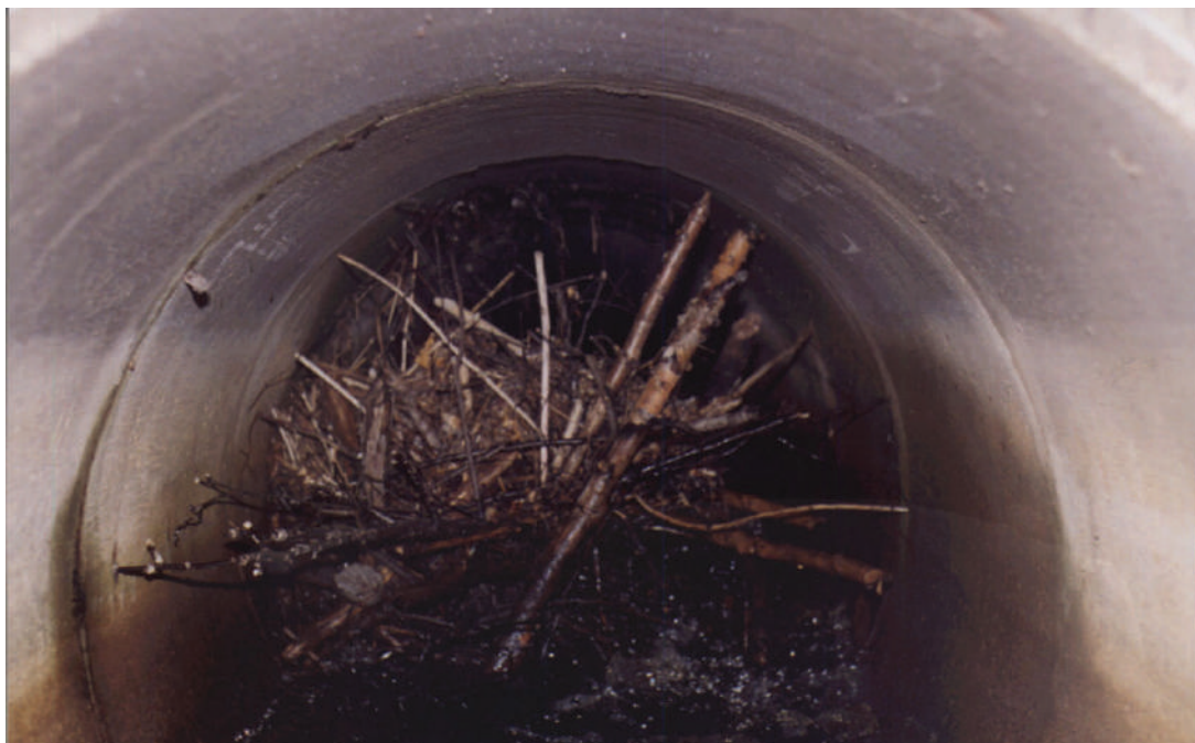
Фото 21. Костомукшский заповедник. Дорожная труба, перекрытая бобрами. Фото Ф.В. Фёдоров.
