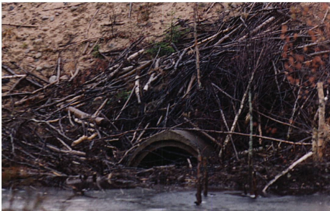
Фото 20. Костомукшский заповедник. Дорожная труба, перекрытая бобрами. Фото Ф.В. Фёдоров.
