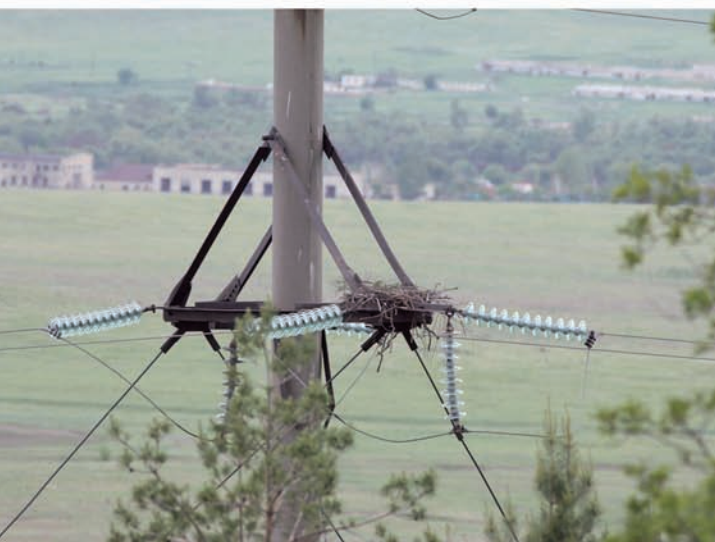
Илл. 35. Высоковольтная линия электропередачи
