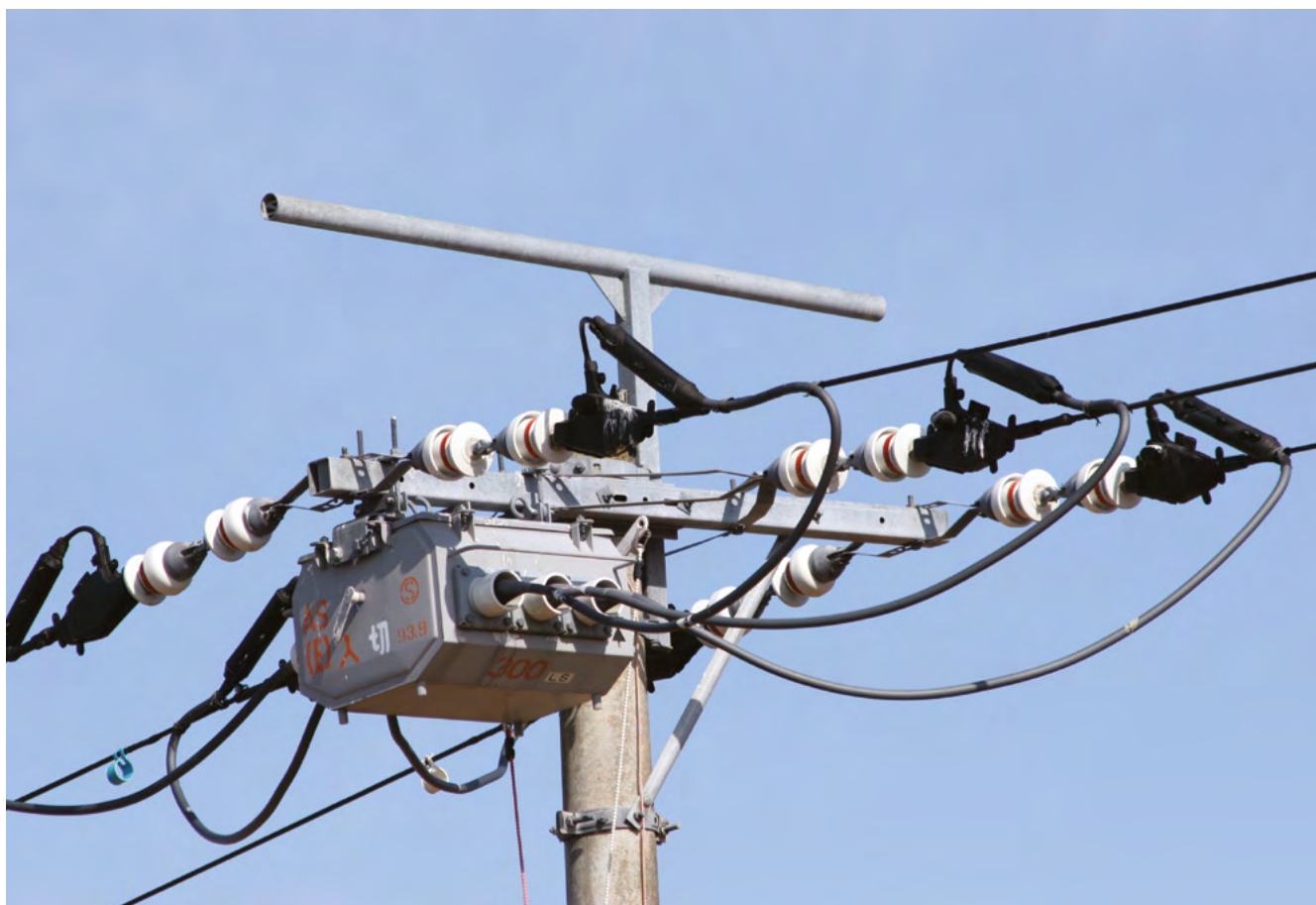
Птицезащитные устройства на опорах ЛЭП. Фото В. Мастерова.
