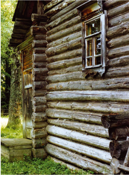
Рис. 17. Северная стена крестьянской избы, зараженная северным, домовым и грабовым точильщиками.
