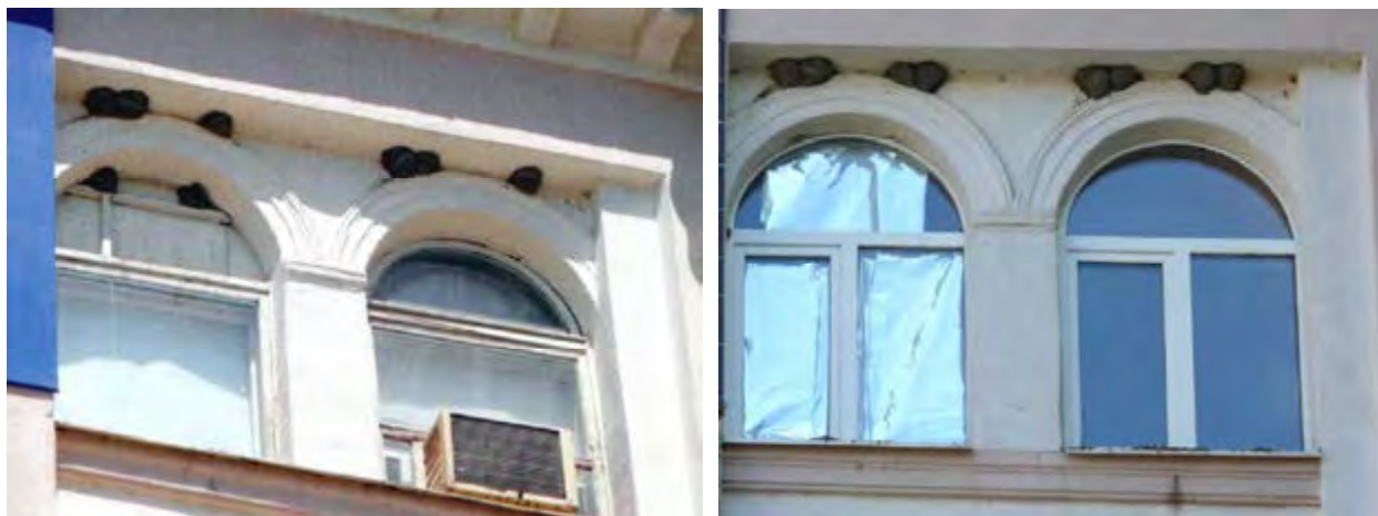
Рис. 5.5.12. Гнезда воронка над и под арками окон 4-го этажа на ул. Ленина, 73 в 2009 г. (слева) и 2012 г. (справа). Фото: Ю. Черненко, А. Нумерова.
