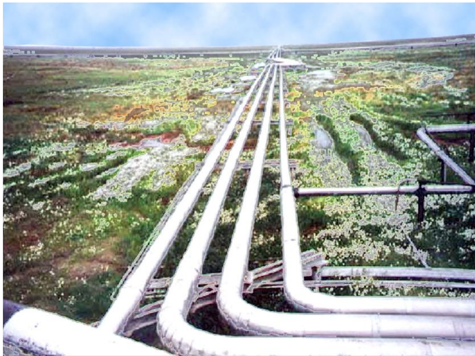
Рис. 6.48. Трубы нефтепроводов в тундре
